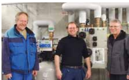
v.l. Werner Bolliger, Hauswart der Schulhäuser Späri und Oberdorf; Beat Studer, Brunnenmeister, und Vlado Simov, Hauswart der Raiffeisen-Arena, besprechen die komplexe Technik im «Untergrund» der Raiffeisen-Arena.
