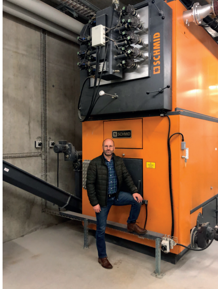
Martin Kamber vor dem Heizkessel in der Zentrale der Raiffeisen Arena
