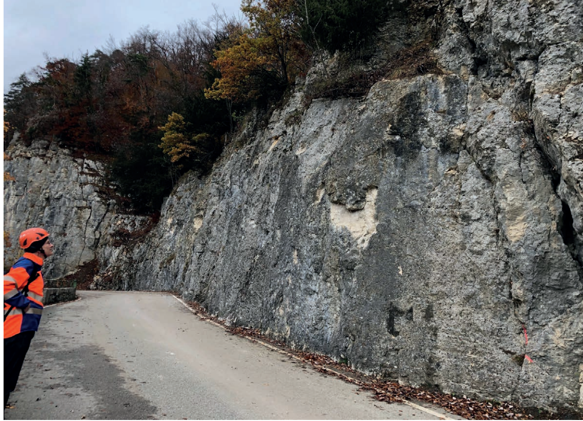
An der weissen Stelle wurde der lose Fels abgeschlagen.
