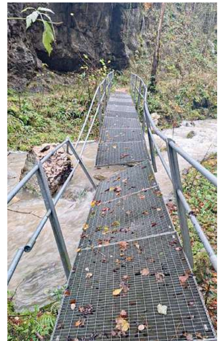
Der Schaden an der Brücke ist beträchtlich.
